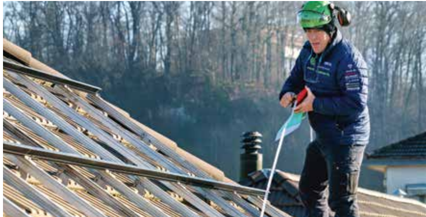
Miteigentümer des Generationenhauses ist Tobias Oetiker (mittleres Bild). Mit seiner Familie und Selbstbauern aus der Genossenschaft SolAar entsteht die neue Solaranlage auf dem Dach.
