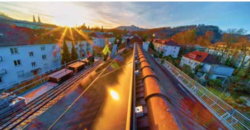
Die Arbeiten auf dem Dach des Generationenhauses in Olten gehen bei unserem Besuch an einem Samstag im Februar mit wenigen Abstimmungsproblemen gut voran – wenige Tage danach steht die Anlage.
