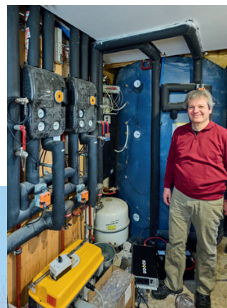
Manuel Hutterli hat mit dem Energiesystem seines Hauses Systemgrenzen überwunden.
